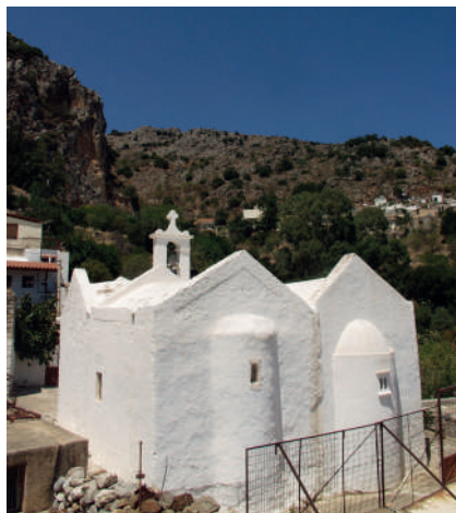
Εικ. 1: Ναός του Αφέντη Χριστού στην Κριτσά, πριν την έναρξη των αναστηλωτικών εργασιών το 2011. Άποψη από ΝΑ.
